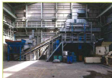
廃プラスチック類処理ライン
